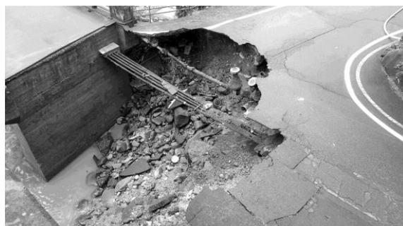
① 県道長野真田線の四日市橋脚の崩落
