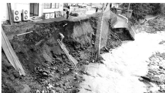
② 上小森林組合事務所建屋と真田地域自治センターの駐車場脇が崩落
